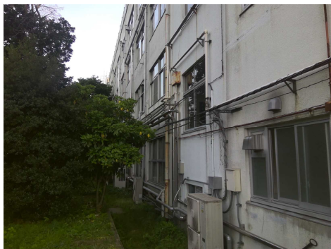
既存空調室外機状況
