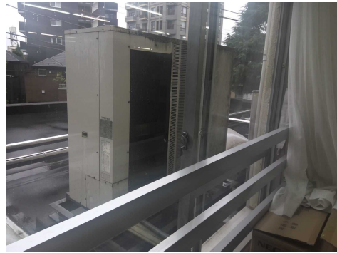
既存空調室外機状況
