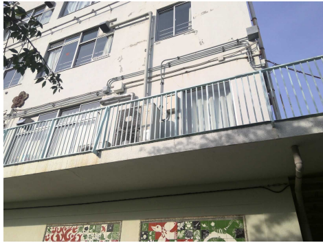
既存空調室外機状況
