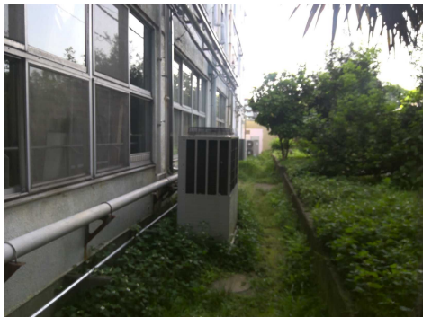
既存空調室外機状況
