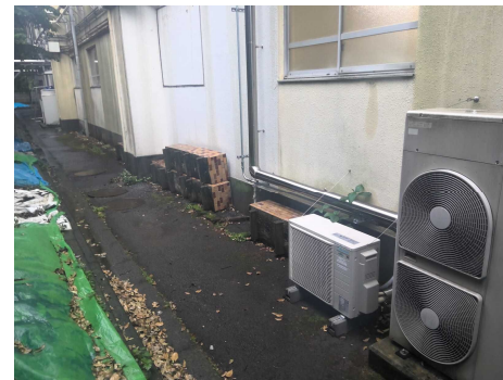
既存空調室外機状況
