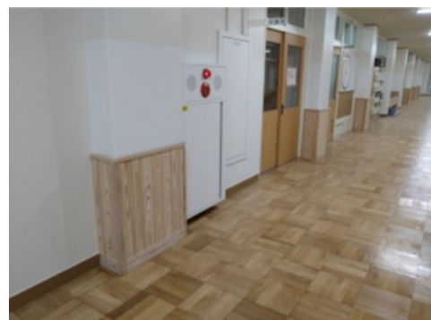
金富小学校の腰壁
