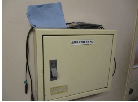
準備室空調制御盤
