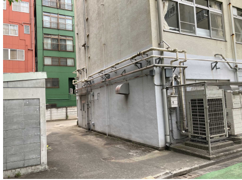
空調室外機状況
