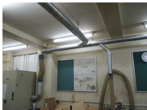
集塵機、ダクト
