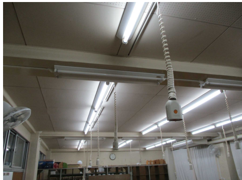
照明器具、リーラーコンセント
