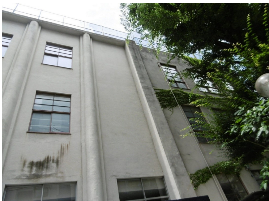
22-02-東棟ダストシュート外観
