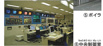
⑥中央制御室
