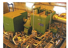
⑪汚水処理設備
