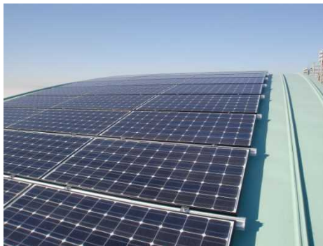
太陽光パネル
