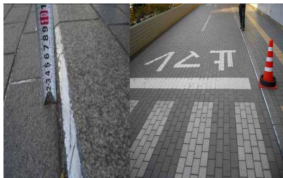
C) 構内道路と歩道の段差
