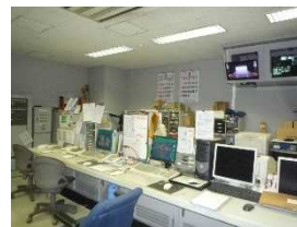
中央監視装室
