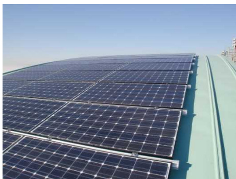
太陽光パネル
