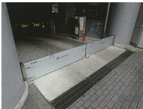
駐車場入り口 止水板
