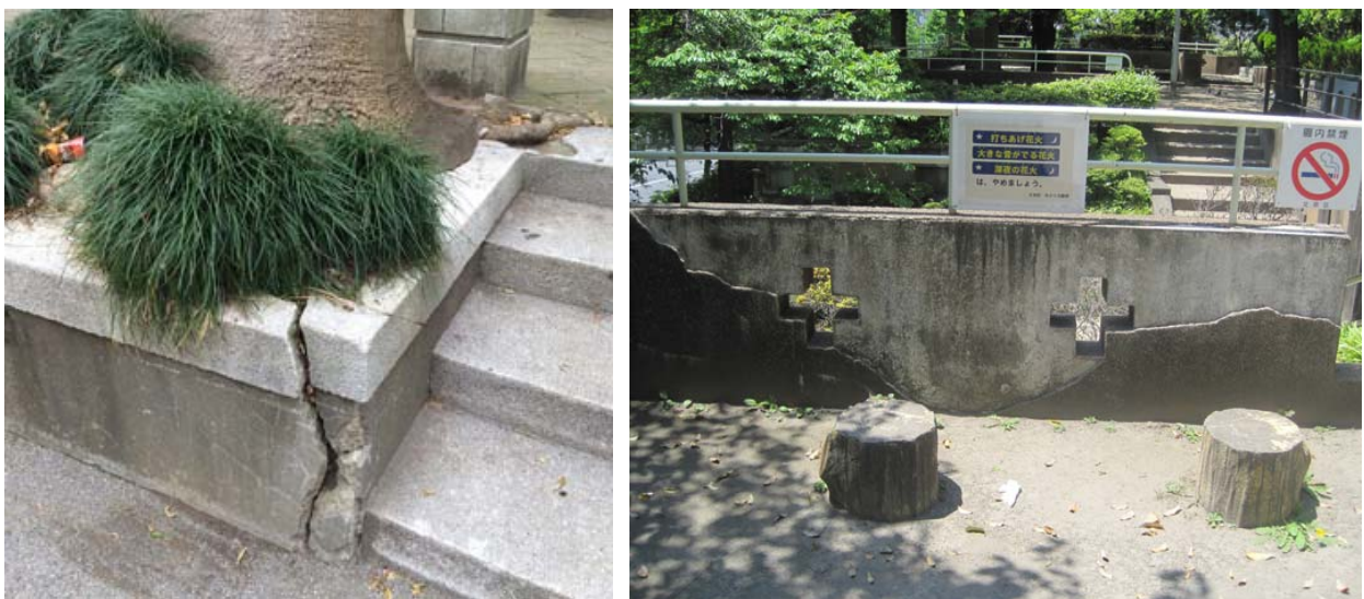
写真-21：元町公園 劣化が顕著な部分
