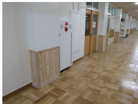
（事業2：区立金富小学校の腰壁）
