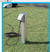
屋外コンセント
