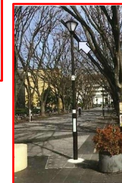
蓄電池式照明灯
