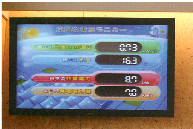
②太陽光発電モニター 発電量等の情報を昇降口のモニターに表示することで、生徒の再生エネルギーへの関心を高めます。
