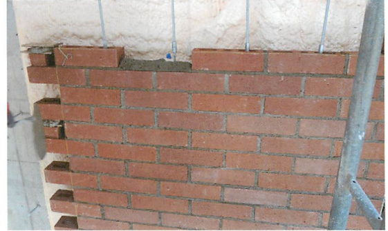
③外断熱仕上げ 外壁には煉瓦を採用し、建物躯体との間に空気層を設けることにより、冷暖房の高効率化を図っています。
