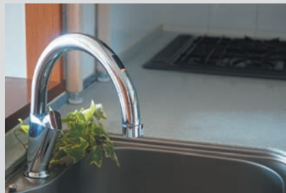
蛇口の水漏れ
