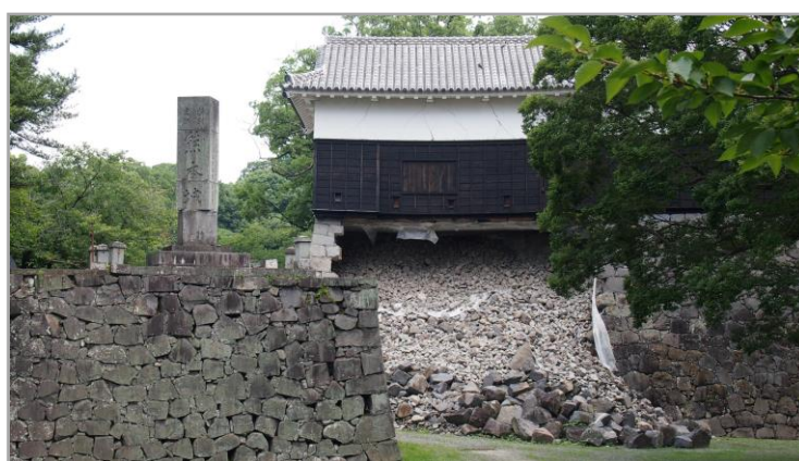
被害を受けた熊本城敷地内の石垣
