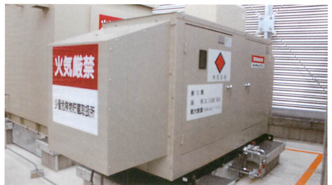
②防災用発電機 東棟塔屋に発電機を設置し、災害時の電力の確保やエレベータによる防災機材の運搬に利用できます。
